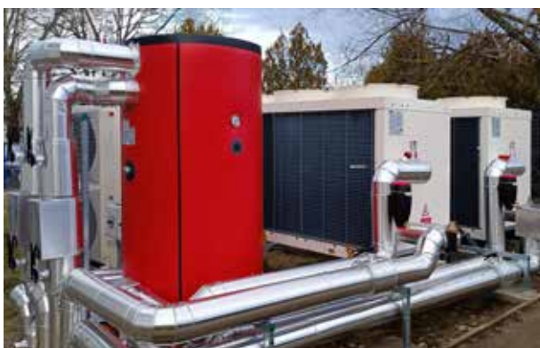
Primavet Produkt Kft., Budapest - 3 db Hoval Belaria® fit hőszivattyú, 2 db Hoval TopGas® gázkazán, Hoval CombiVal E puffertartály
