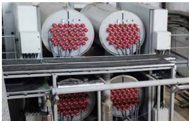
Távhőszolgáltató, Almásfüzitő - Ecotherm elektromos kazán (5040 kW)
