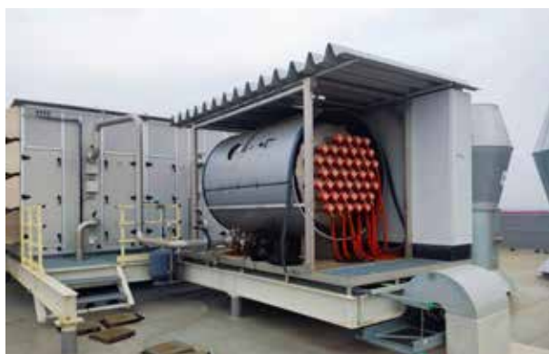
Biofinomító, Dunaföldvár - 1 db Ecotherm elektromos kazán (1440 kW)
