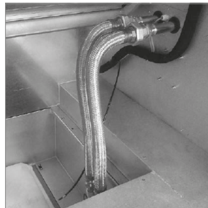
Kép: Fűtőkör csatlakozása
